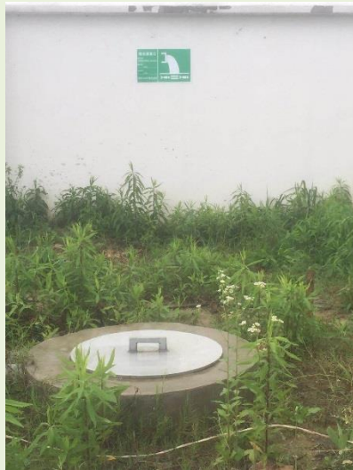
雨水排放口及标识牌
